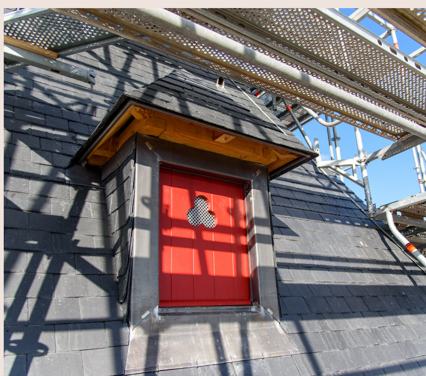
Couverture achevée du clocher et lucarne peinte en rouge sang de bœuf *
