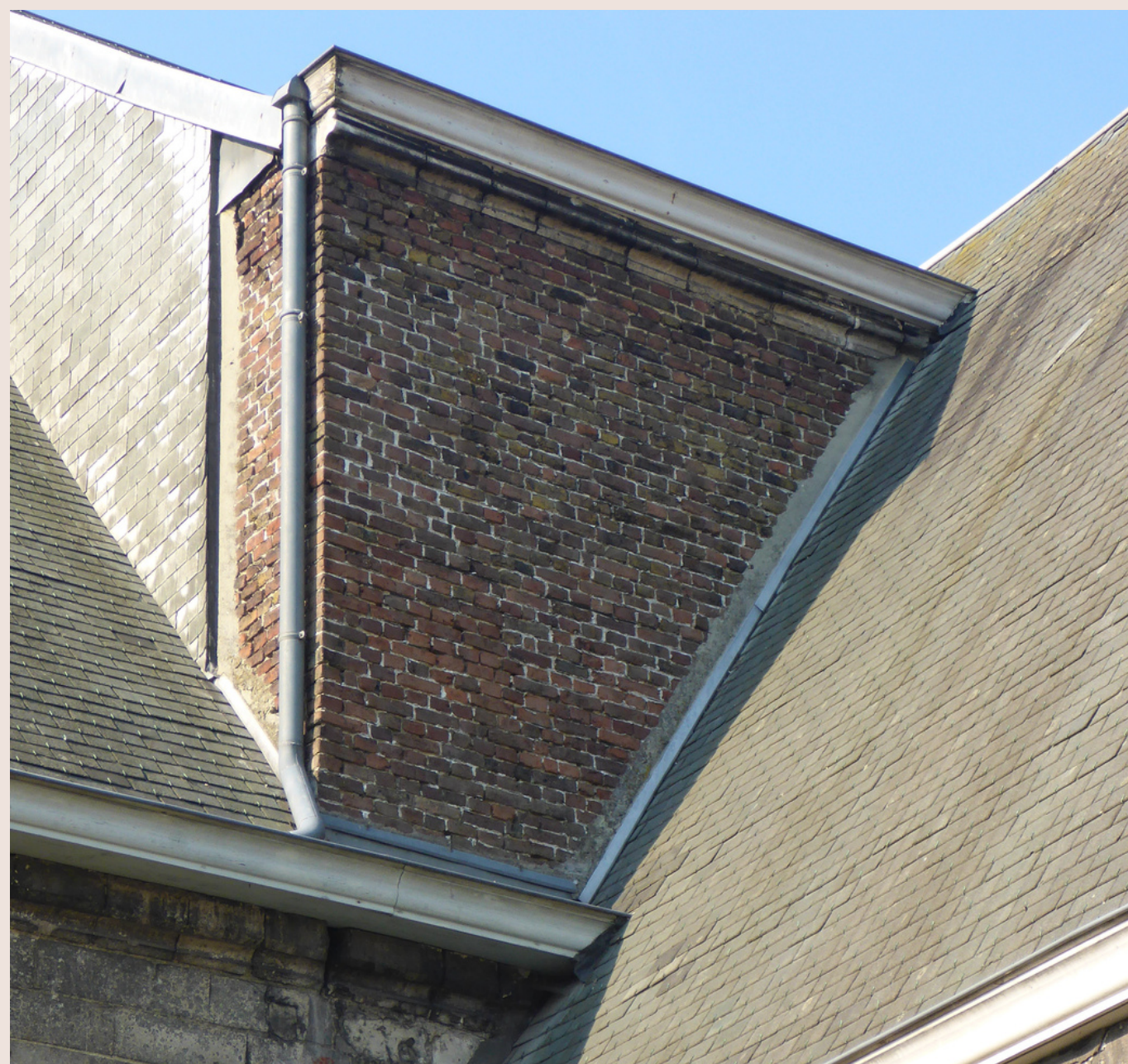
3 Déjointoiement du mur en brique
