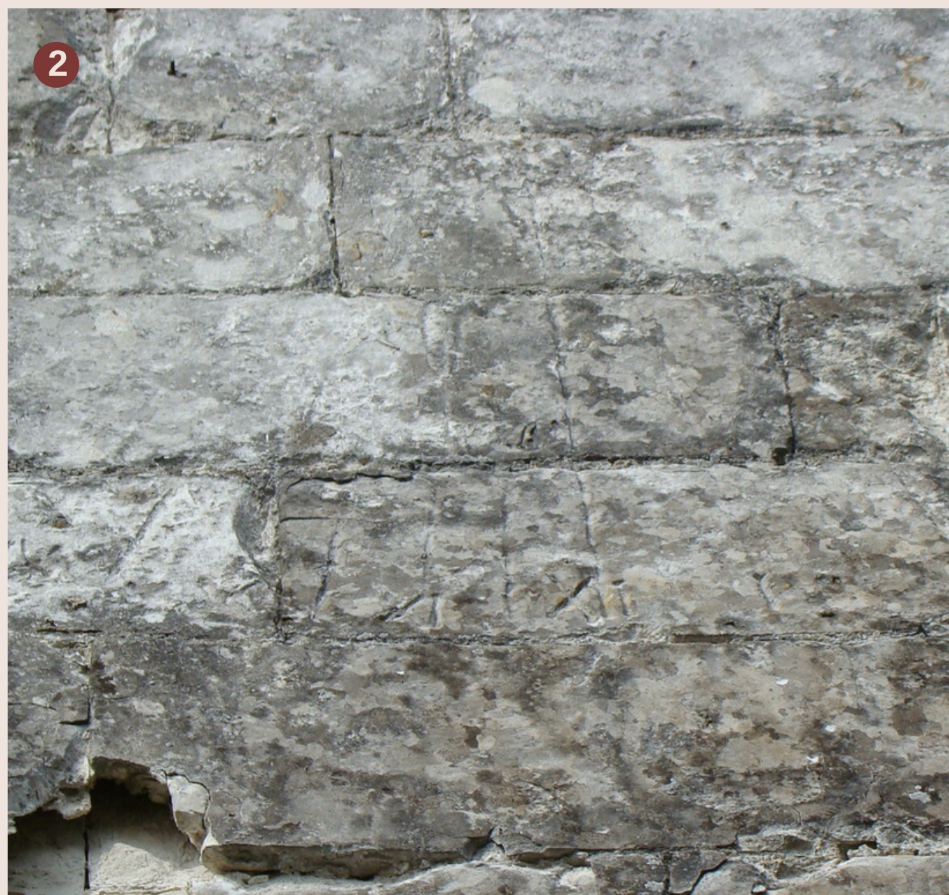
2 Traces de l'ancien cadran solaire en cours de disparition
