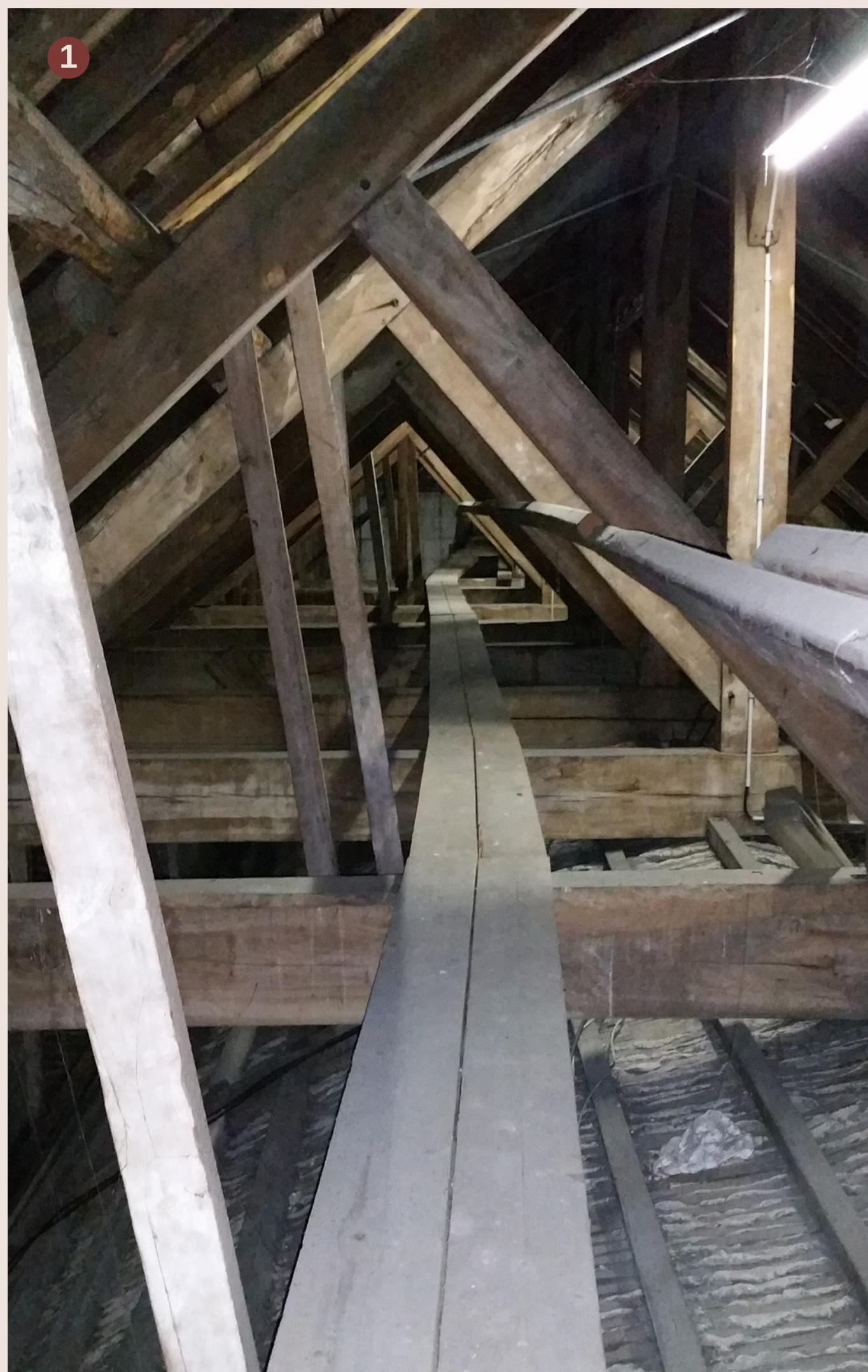
Accès dangereux à la charpente de la nef
