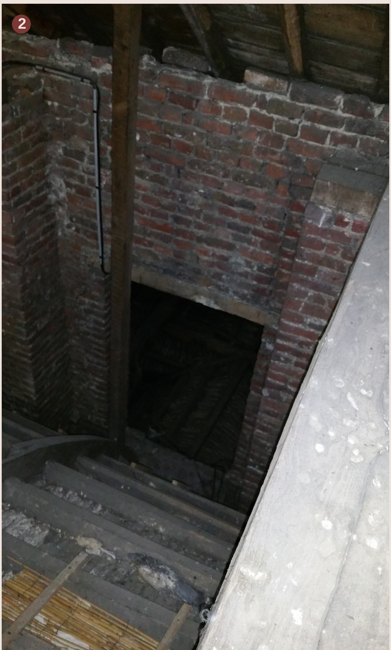
Rehaussement des murs gouttereaux et problème d'accessibilité aux charpentes des bas-côtés
